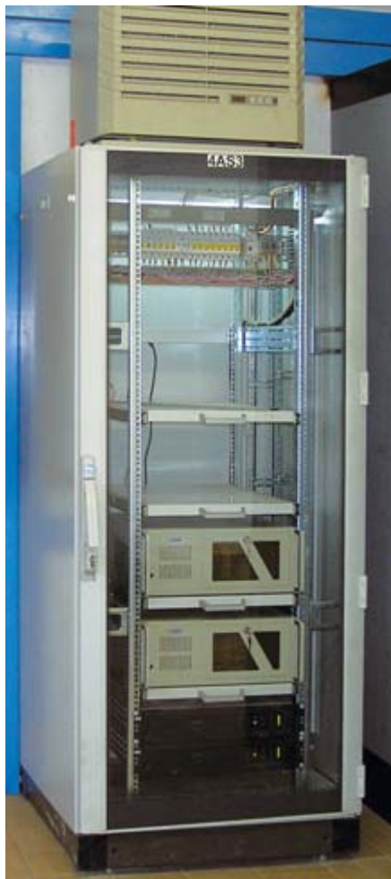
Рис. 4. Шкаф Rittal с промышленными компьютерами
